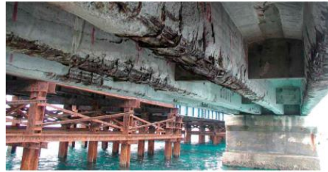
中の鋼材が腐食し、コンクリートが剥がれ落ちたところ
